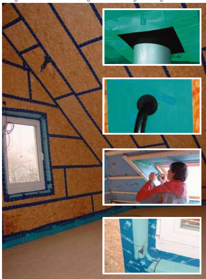
De meest kritische details situeren zicht ter hoogte van de aansluitingen van wanden met vloeren en wanden met buitenschrijnwerk. Afkleven van alle naden, voegen, leidingdoorvoeren en raamaansluitingen is dus van zeer groot belang
